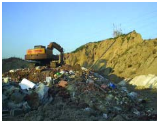
Abocament de runes de construcció darrere de les naus de Puigmadrona
